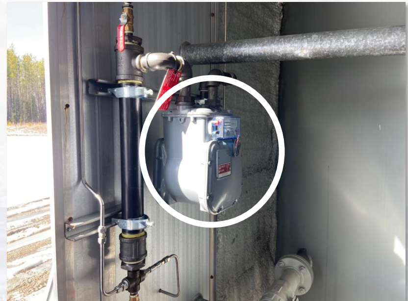
Vent Gas Meter
