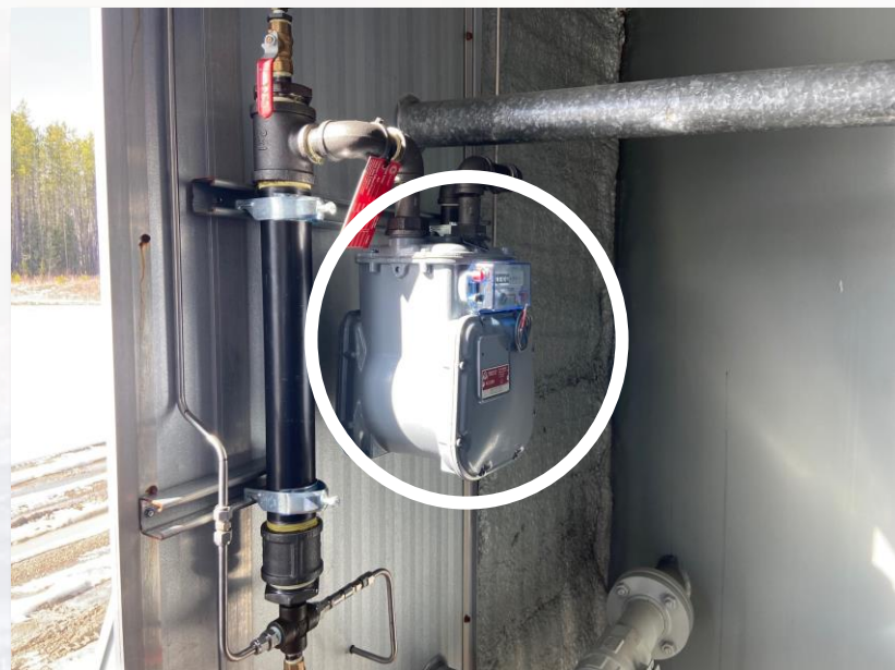
Vent Gas Meter
